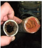
Sistema de tuberías
