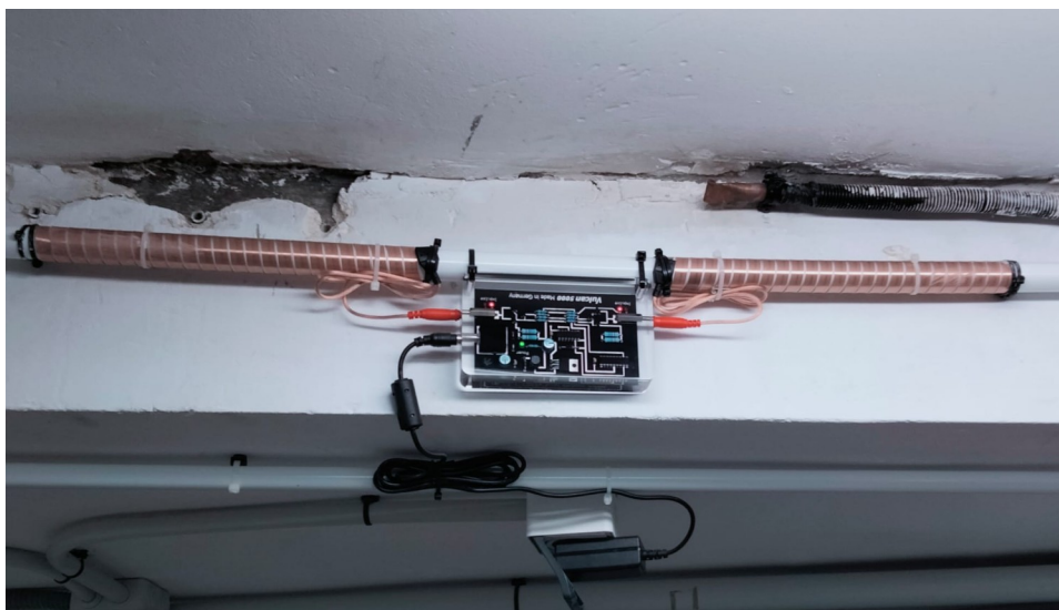
Vulcan 5000 an der Hauptleitung Kaltwasser
