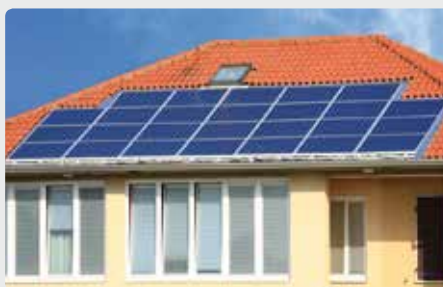
Solaranlage eines Privathauses
