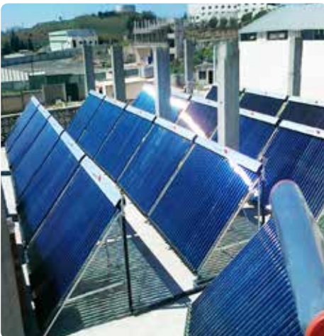
Solarheizpaneele auf dem Dach eines Wohnhauses
