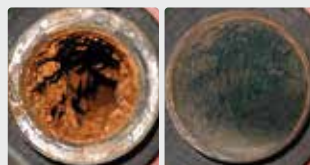
Sistema de tuberías
