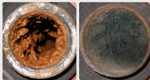
Biopelícula en un sistema de tuberías
