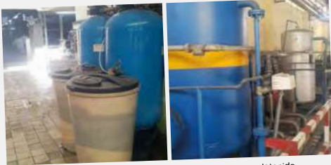
Ablandador de agua funcionando
