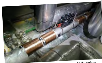
Vulcan S25 instalado en Toray Industries
