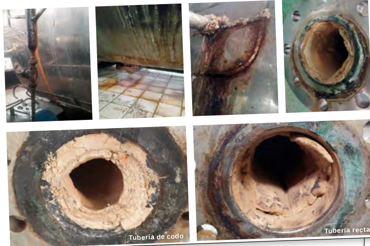
Tubería de retorno del agua caliente al intercambiador de calor para su enfriamiento
