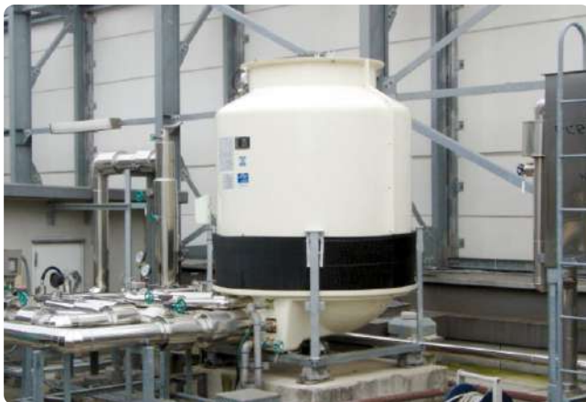
Torre de refrigeración
