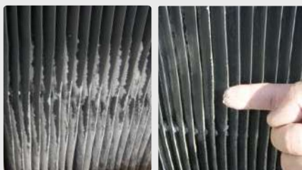
Rejillas de torres de refrigeración
