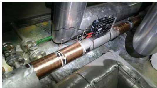
Vulcan S25 instalado en Toray Industries
