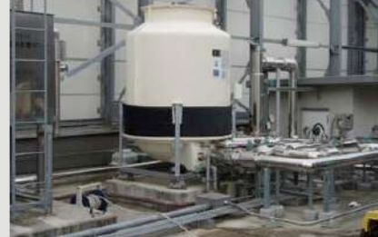
Torre de refrigeración C
