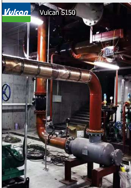
Sistema de calefacción del área comercial
