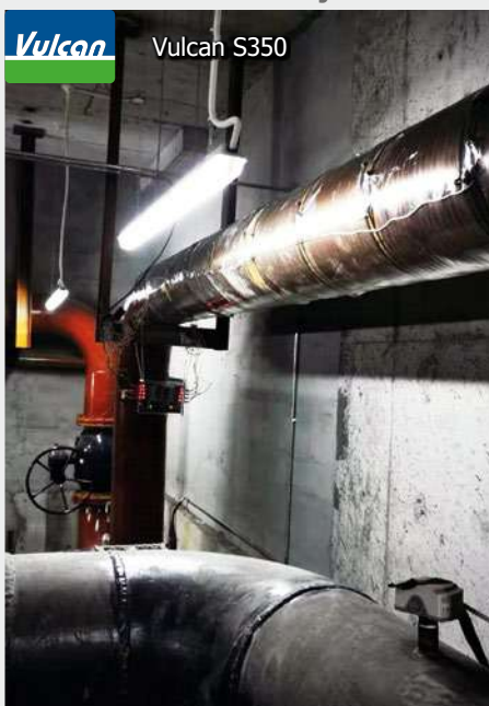
Sistema de calefacción de la zona baja
