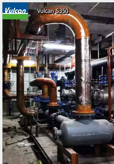
Sistema de calefacción de la zona alta
