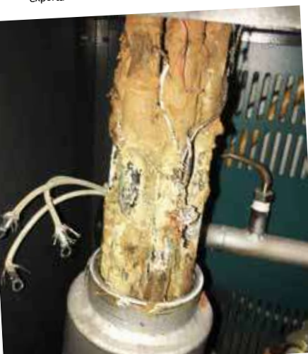
Intercambiador de calor sin mantenimiento por 3 años.
