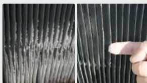
Rejillas de torres de refrigeración
