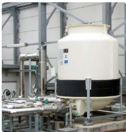
Torre de refrigeración
