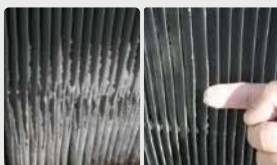
Rejillas de torres de refrigeración
