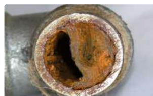
Tubería con incrustaciones de cal
