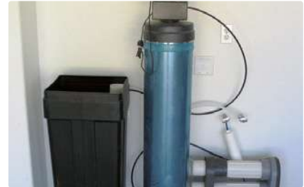
Sistema de ósmosis inversa
