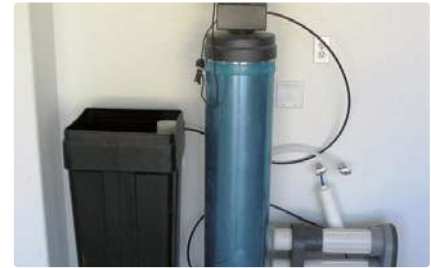
Sistema de ósmosis inversa
