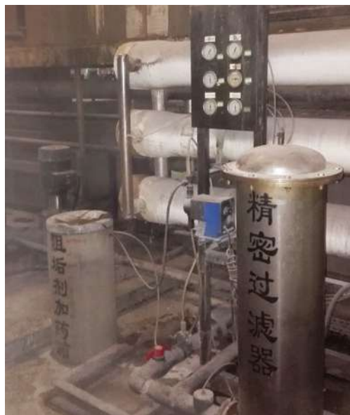
Equipo de procesamiento de agua pura.
