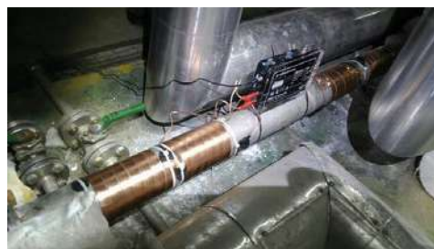
Vulcan S25 instalado en Toray Industries
