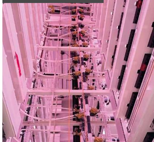
Boquillas de riego del invernadero
