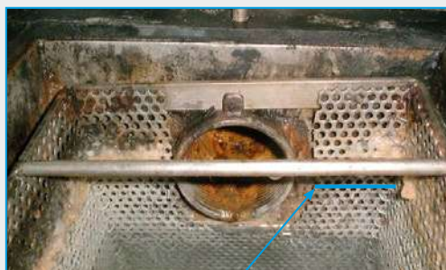
Nivel normal de agua estancada.
