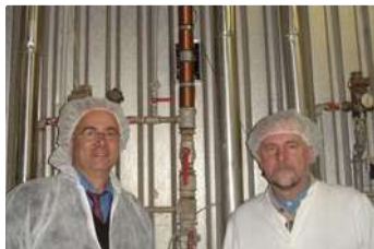
Vulcan instalado en una fábrica de alimentos
