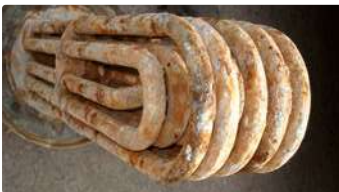
Tubería de un intercambiador de calor
