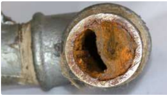
Tubería con depósitos calcáreos
