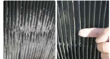
Rejilla de torre de refrigeración
