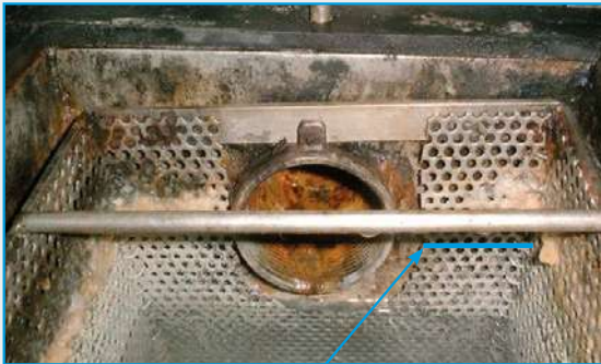
Nivel normal de agua estancada.
