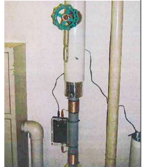
Vulcan 5000 wurde in der Fabrikküche installiert
