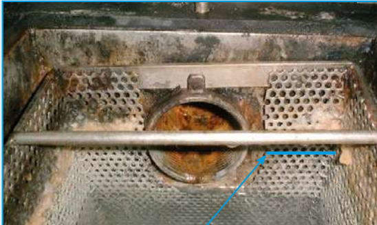
Übliche Menge an stehendem Wasser.
