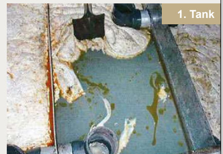
2. Tank - 10 mm dicke Ölschicht
