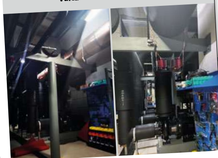
Vulcan S500 en el edificio B
