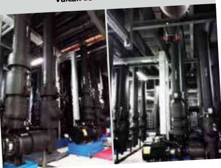
Vulcan S500 in Gebäude A
