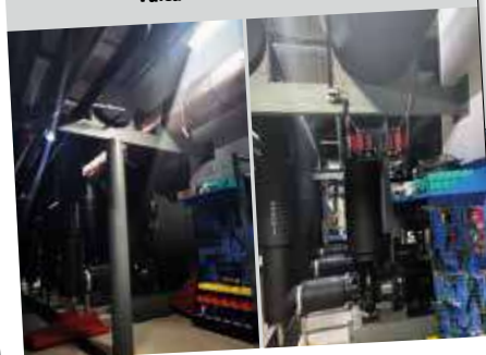
Vulcan S500 in Gebäude B
