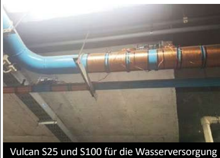
Vulcan S25 und S100 für die Wasserversorgung
