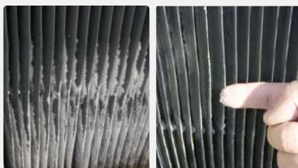
Kühlrippen eines Kühlturmes
