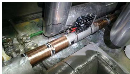
Vulcan S25 installiert in der Toray Fabrik
