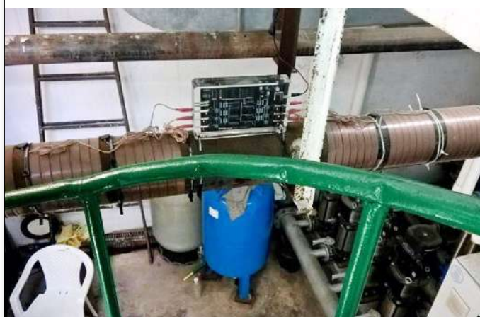
Zwei Vulcan S100 sind im Hotel installiert.
