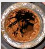
Sistema de tuberías
