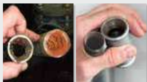
Sistema de tuberías
