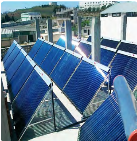
Solarheizpaneele auf dem Dach eines Wohnhauses
