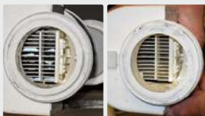
Filtro de piscina
