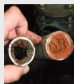
Sistema de tuberías
