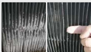
Rejillas de torres de refrigeración
