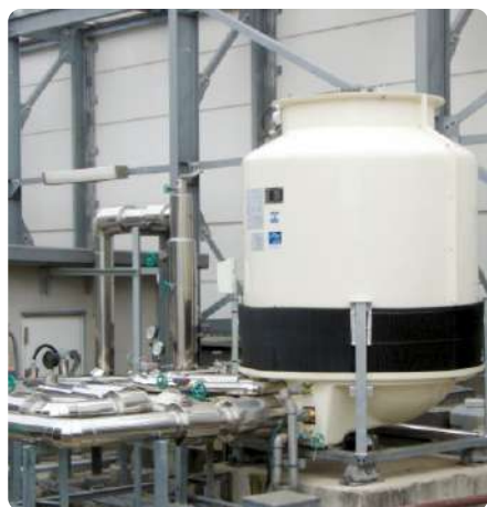
Torre de refrigeración
