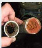
Sistema de tuberías
