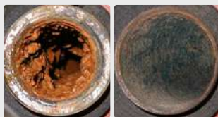
Biopelícula en un sistema de tuberías
