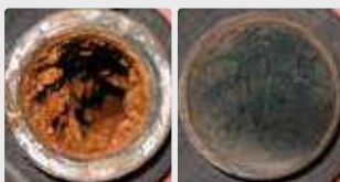
Biopelícula en un sistema de tuberías
