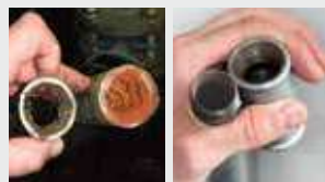
Sistema de tuberías
