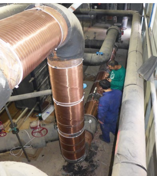
El equipo Vulcan S500 se instaló en la central de intercambio de calor.
