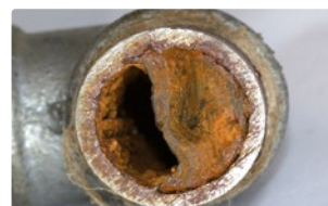
Tubería con incrustaciones de cal
