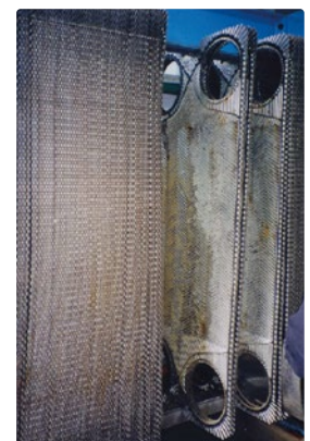
Intercambiador de calor de placas
