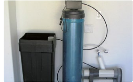
Sistema de ósmosis inversa
