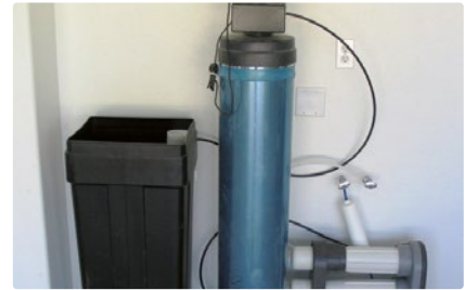
Sistema de ósmosis inversa
