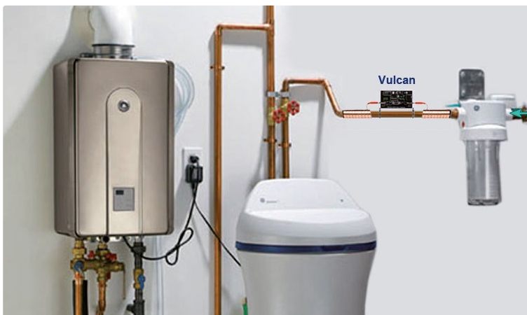
Instalación de Vulcan junto a un suavizador de agua
