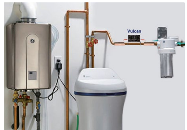
Vulcan Installation vor einem Ionentauscher
