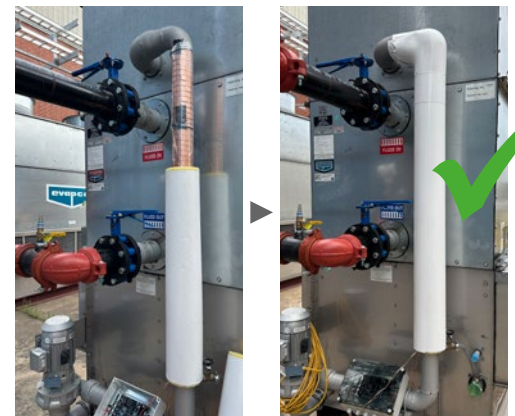
Rohrisolierung im Freien zum Schutz der Impulsbänder.
