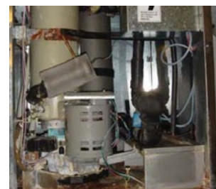
Vulcan schützt die Eismaschine
