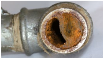
Tubería con depósitos calcáreos
