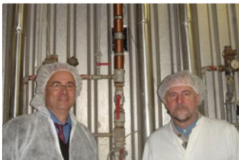
Vulcan instalado en una fábrica de alimentos
