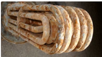
Tubería de un intercambiador de calor
