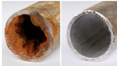
Sistema de tuberías
