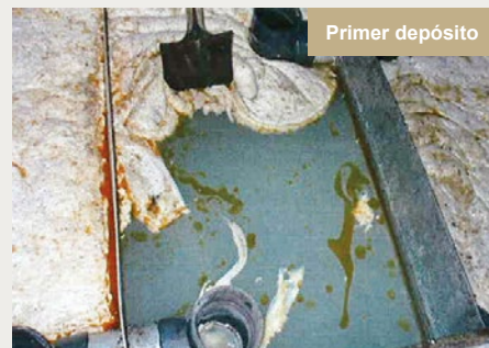
2 do depósito – capa de grasa de 10 mm de grosor
