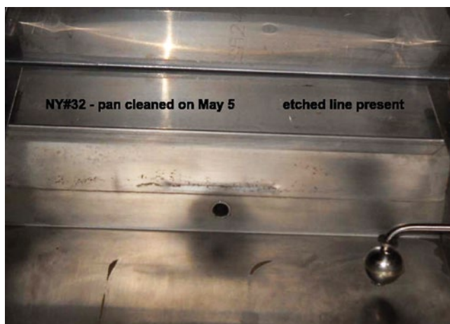
Después de la instalación de Vulcan: el área de la bandeja ahora está totalmente libre de cal. Se observa una leve hendidura en la línea de flotación de la bandeja.
