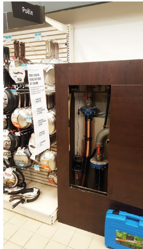
Vulcan S25 wurde in der Wasserleitung installiert, um das gesamte Gebäude zu behandeln.
