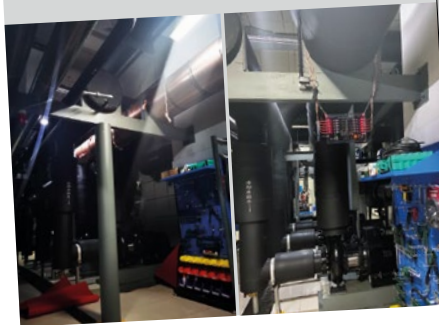
Vulcan S500 en el edificio B
