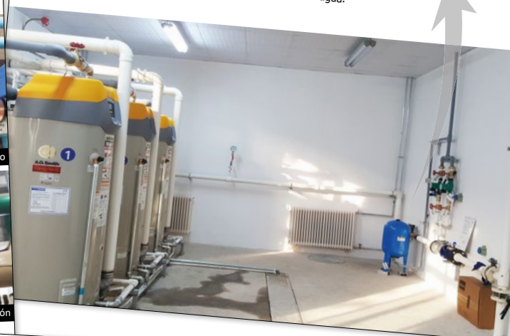
El Vulcan S10 se instaló delante del calentador de agua.
