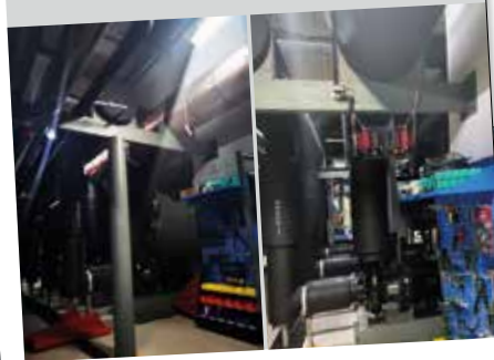
Vulcan S500 in Gebäude B
