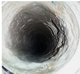
2 Wochen nach der Vulcan Installation: Kalk wurde weicher und löste sich
