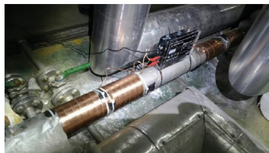
Vulcan S25 installiert in der Toray Fabrik
