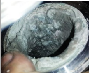
Vor der Vulcan Installation: Die Rohre sind voller Kalk
