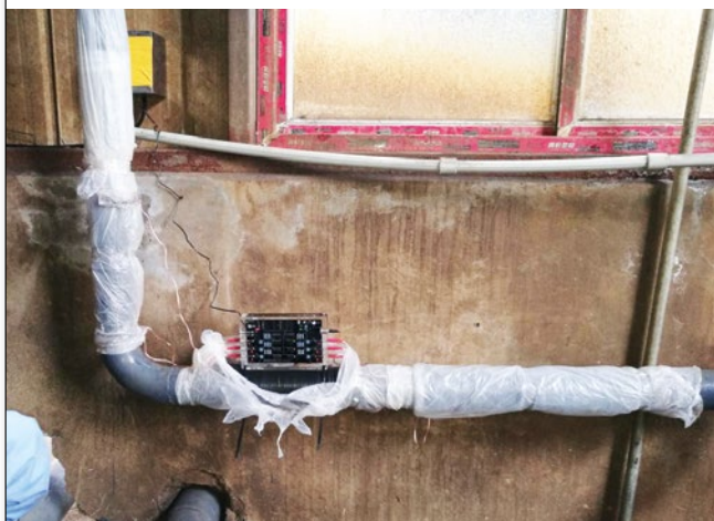
Vulcan S100 wurde im Abwasserraum installiert, um die Schlammentwässerungsmaschine zu behandeln.
