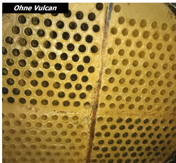
Vor dem Einbau von Vulcan war der Kalk in den Wärmetauscherrohren sehr dick und hart.
