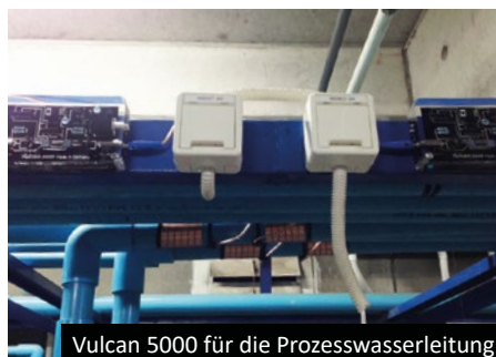
Vulcan 5000 für die Prozesswasserleitung
