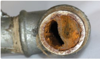
Stark befallenes Rohr
