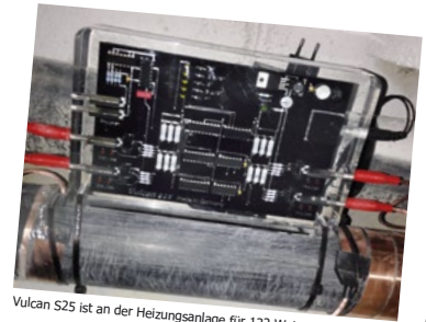
Vulcan S25 ist an der Heizungsanlage für 132 Wohnungen installiert
