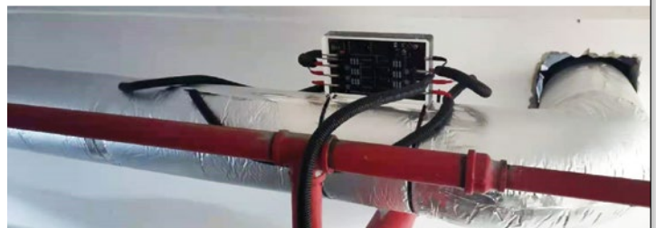
Ein Vulcan S100 ist für den Warmwasserbereiter der Luftwärmepumpe in Wohnhaus 2 installiert.
