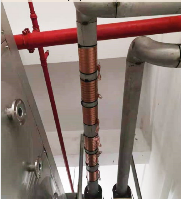
Ein Vulcan S100 ist für den Warmwasserbereiter der Luftwärmepumpe in Wohnhaus 1 installiert.
