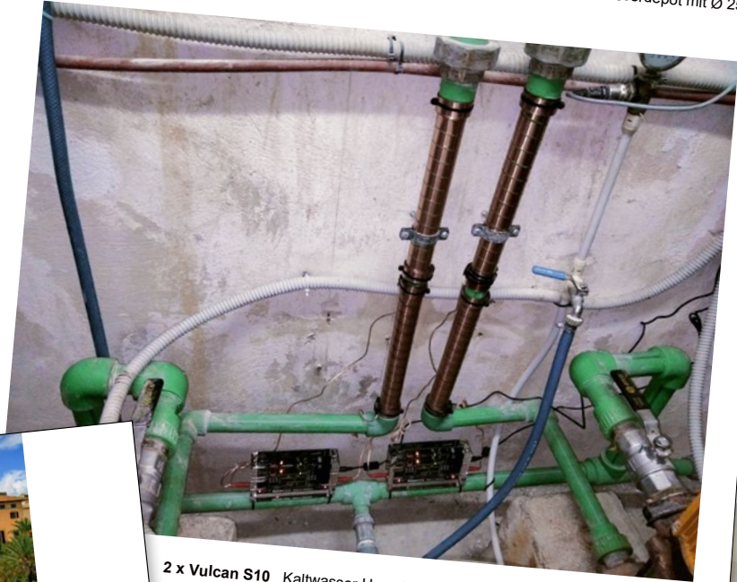
2 x Vulcan S10 Kaltwasser Hauptleitung mit Ø 41 mm
