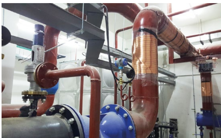
Vulcan S350 wurde im Heizsystem des oberen Bereichs in der Wärmetauschstation installiert.
