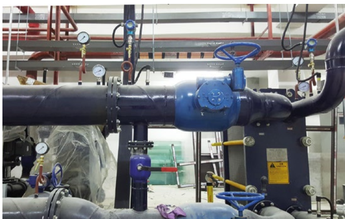
Vulcan S150 wurde im Heizsystem des unteren Bereichs in der Wärmetauschstation installiert.
