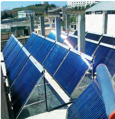
Solarheizpaneele auf dem Dach eines Wohnhauses
