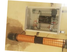
Vulcan S10 se instaló en la red principal de agua para tratar 6 sistemas de refrigeración en 3 criaderos de aves
