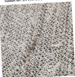
Ohne jegliche Wasseraufbereitung war der Kalk hart wie Stein, die seit mehr als 5 Jahren nicht mehr gereinigt worden waren.
