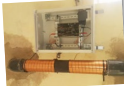
Vulcan S10 wurde in der Wasserleitung installiert, um 6 Kühlsysteme in 3 Hühnerfarmen zu behandeln.
