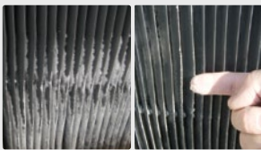
Kühlrippen eines Kühlturmes
